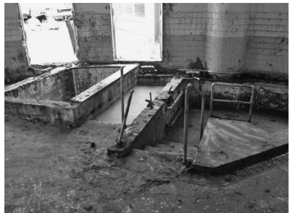
5. 地震と津波で老健の浴槽は、このようになった。
